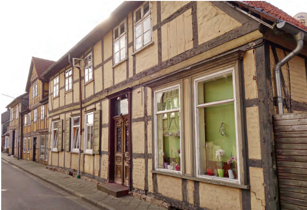
Abb. 2.716 Achterstraße 23 – 27. Eines der letzten Fachwerkensembles in Wittingen mit teils erheblichem Sanierungsbedarf.
