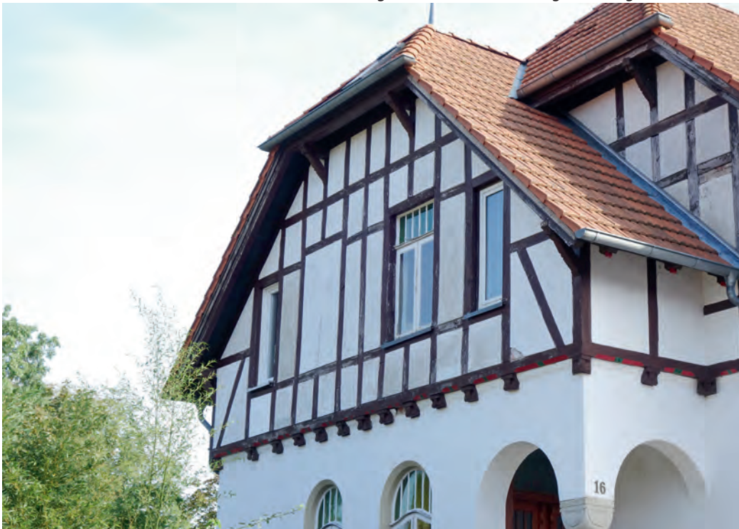
Abb. 2.717 Giebel von Junkerstraße 16. Das aufwendige Fachwerk ist sanierungsbedürftig.
