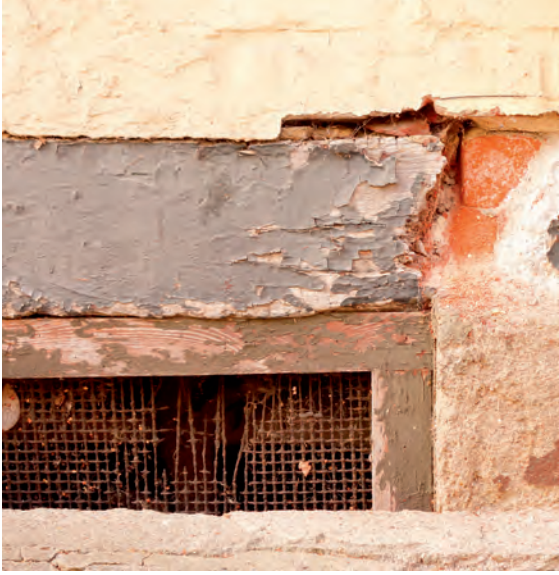
Abb. 2.7/1 Fassadendetail von Achterstraße 23 – erhebliche Mängel an der Bausubstanz
