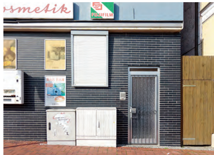
Abb. 3.3/5 ...mit zahlreichen Eingriffen in das Fassadenbild durch z. B. Werbung, Automaten, Rollläden und unabgestimmte Anpassung der Öffnungen.
