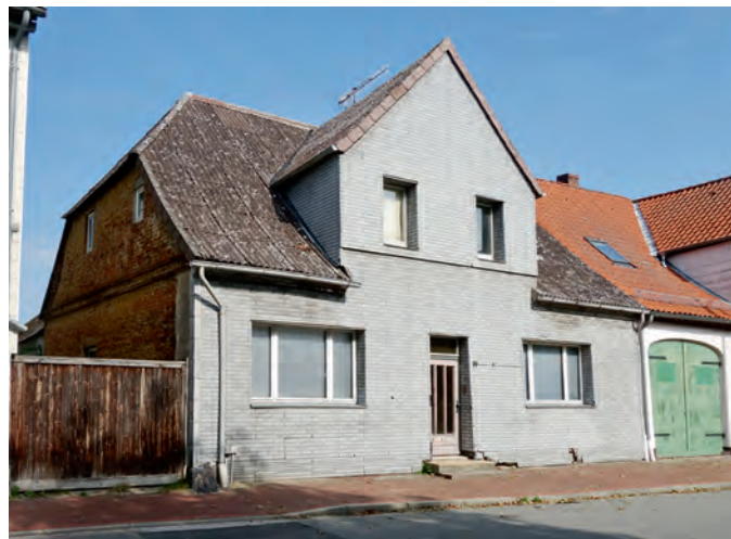
Abb. 3.3/3 Fulau 14: Materielle Verfremdungen an Dach und Fassade, Leerstand, hoher Sanierungsbedarf.
