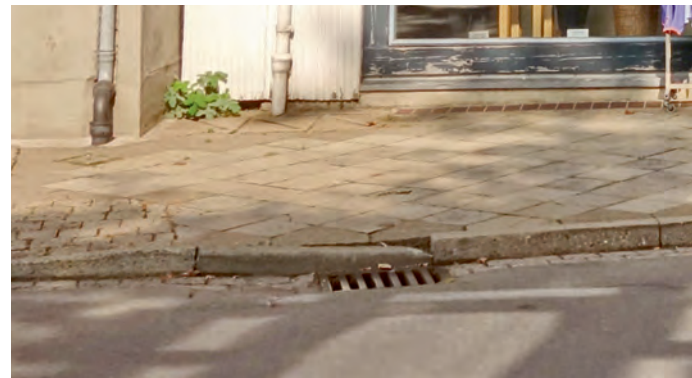
Abb. 5.3/5 Gehwegschäden vor Fulau 4.
