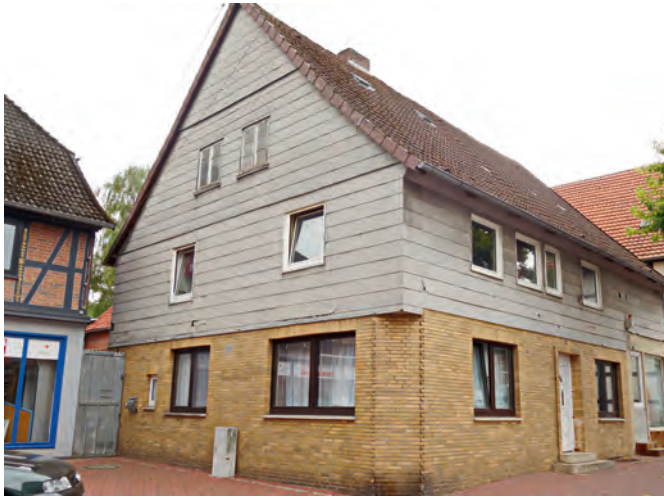
Abb. 5.4/1 Lange Straße 37: hoher Sanierungsbedarf
