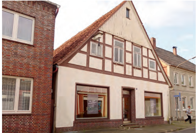
Abb. 2.713 Giebelständiges Haus Achterstraße 37. Das Gebäude steht leer und befindet sich in einem schlechten Zustand.
