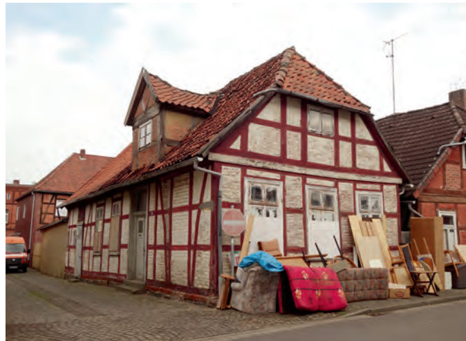
Abb. 3.3/2 Der Fortbestand der denkmalgeschützten Gebäude Achterstraße 28 und 30 (rechts) ist aufgrund zunehmenden Verfalls gefährdet.
