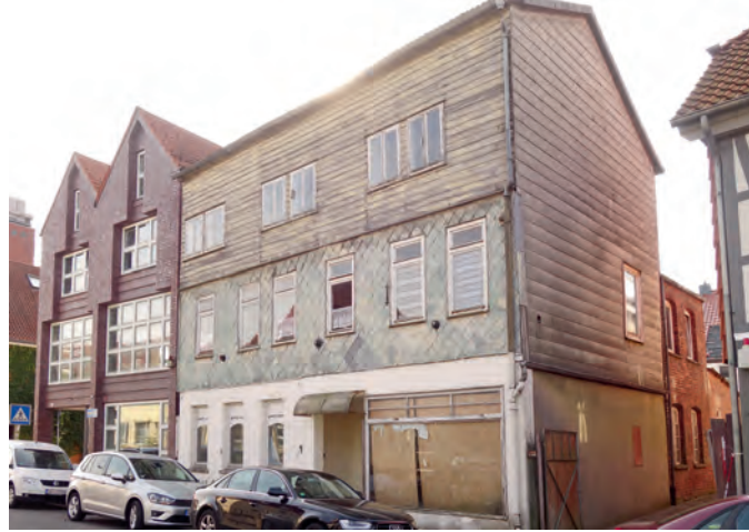
Abb. 3.3/1 Junkerstraße 11. Auf der Rückseite sind bereits Teileinstürze zu verzeichnen.
